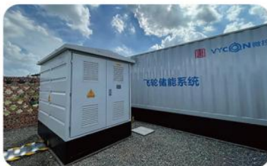
辽宁阜新大唐查台风电场国内首个 “单风机储能一体化”惯量响应及一次调频
