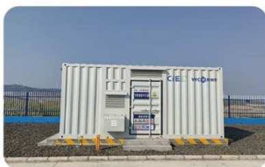
协合新能源辽宁阜新海力板风电场 国内首个“飞轮+锂电池”混合储能调频项目
