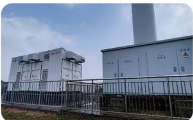
国家能源集团广西天堂顶风电场 “单风机储能一体化”调频项目
