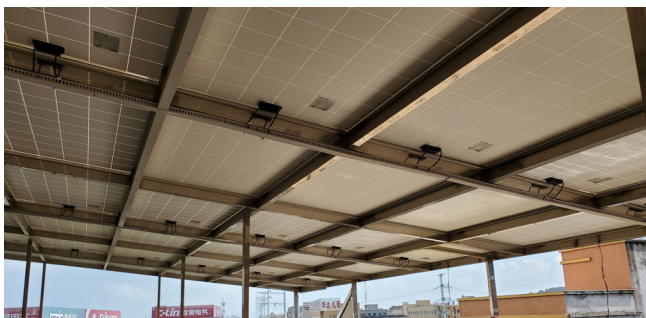
民生光伏贷支持建设的分布式屋顶光伏发电设备
