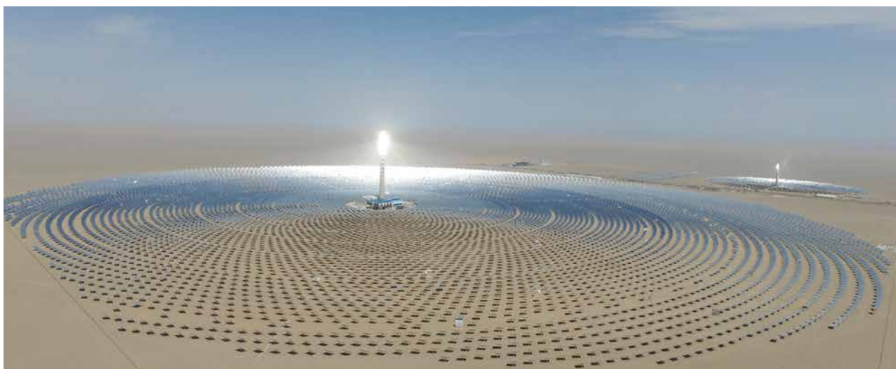
图：首航敦煌 10MW+100MW 塔式光热电站（图片来源：首航高科）
