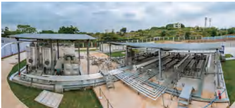
图6 广州南沙小虎岛电氢智慧能源站项目
