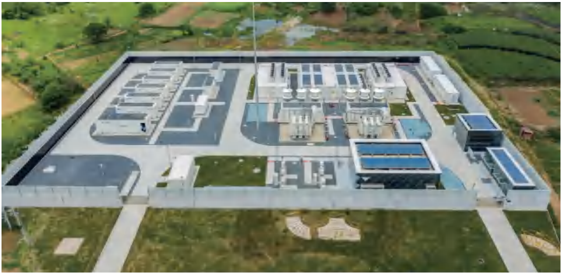
图3 能量路由器站实地现场
