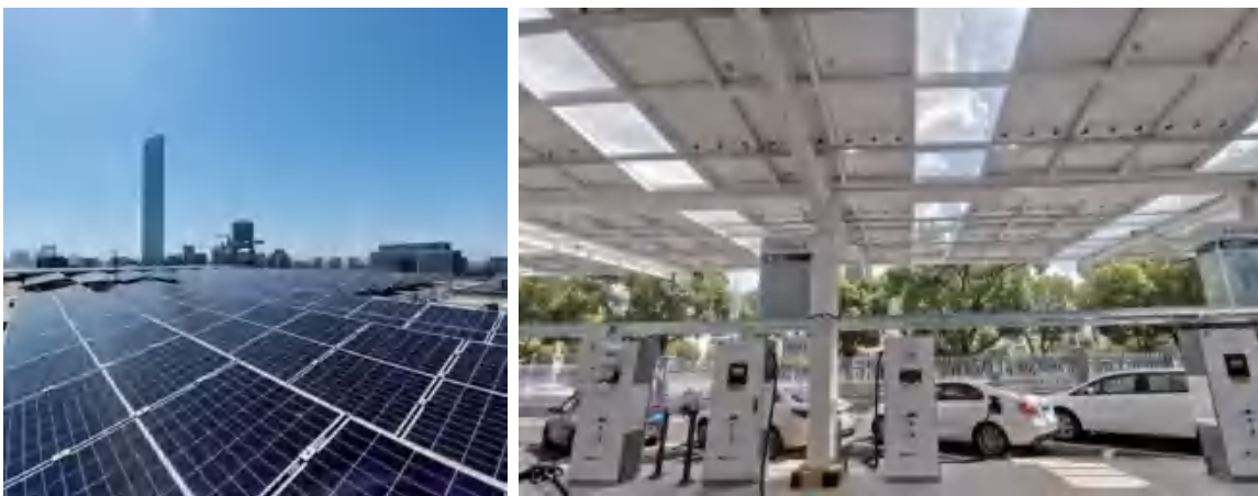
图 4 苏州工业园区光伏、充电桩建设情况
