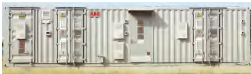
图 3 eStorage 智慧储能小屋
