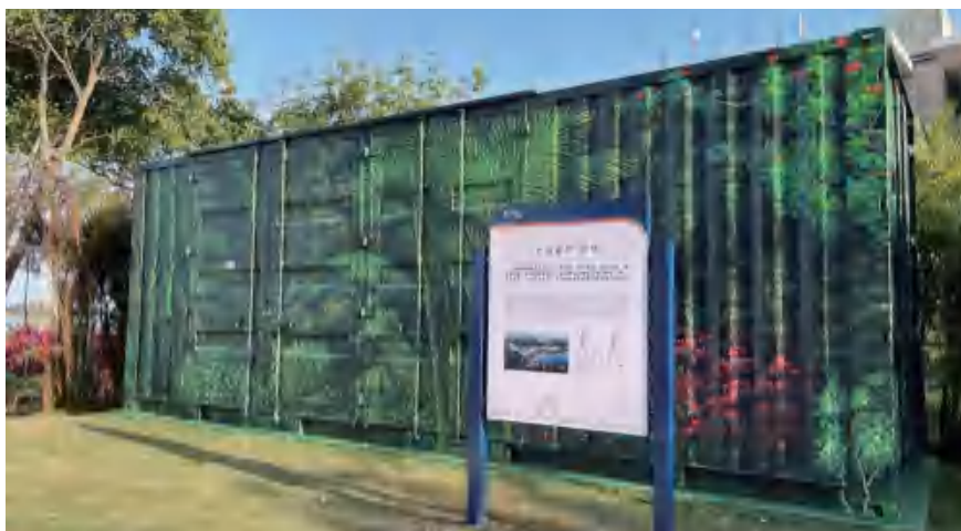
图 3 全钒液流储能设备
