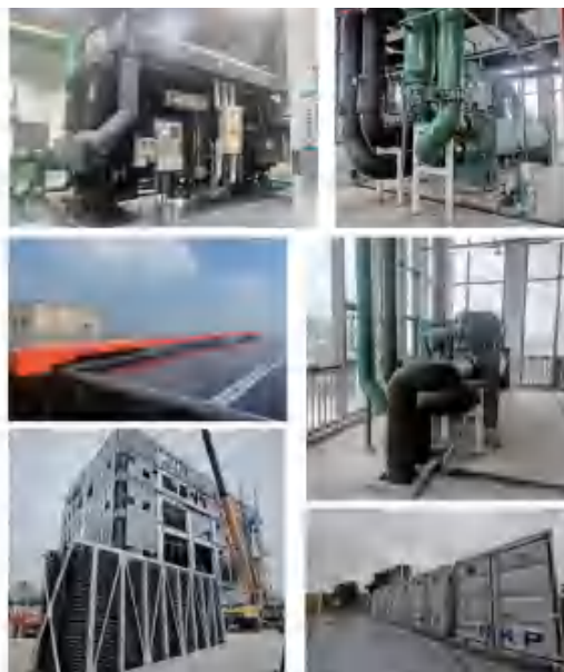
图 2 杭州医药港多能互补区域集中供能项目主要设备情况
