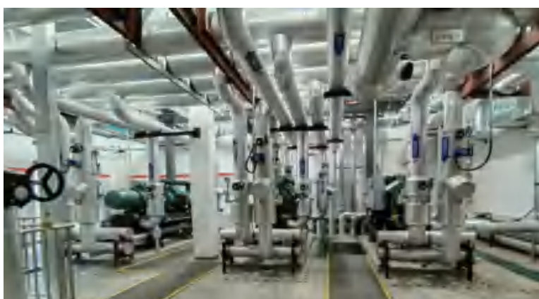
图 7 城市绿心综合能源站实景
