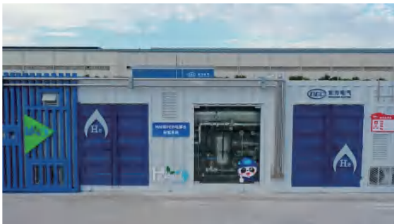
图 1 兆瓦级 PEM 电解水制氢系统
